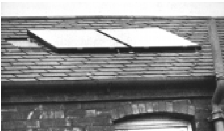
telhado com painéis solares
